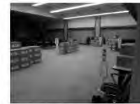
非常電源設備稼働後
