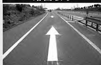
矢印(進行方向)の確認 (本線への合流部)
