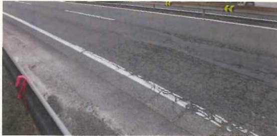
舗装の劣化状況
