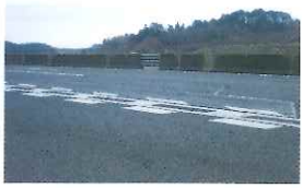
舗装損傷状況
