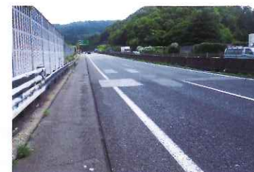
舗装損傷状況
