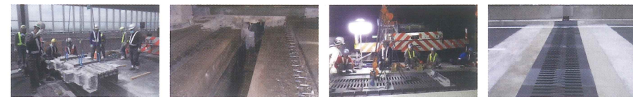
1. 既存の橋梁伸縮装置を撤去、2. 橋梁伸縮装置の撤去後の状況、3. 新しい橋梁伸縮装置の設置、4. 工事完了
