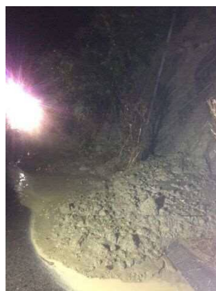
② 山陽自動車道 三木 JCT～神戸西 IC(下) 切土のり面表層流出 お客さまへの被害 なし
