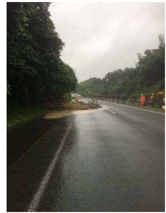
⑥ 九州自動車道 若宮 IC~古賀 IC(上・下) 切土のり面表層流出 お客さまへの被害 なし
